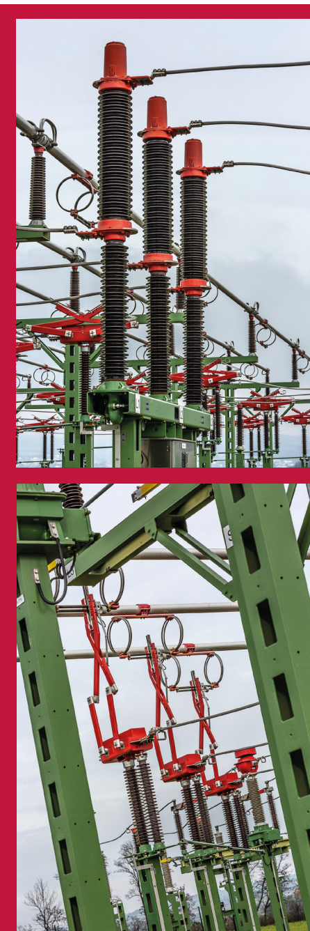
Die Netz Burgenland GmbH betreibt im gesamten Bundesland 21 Umspannwerke. © www.martingold.at
