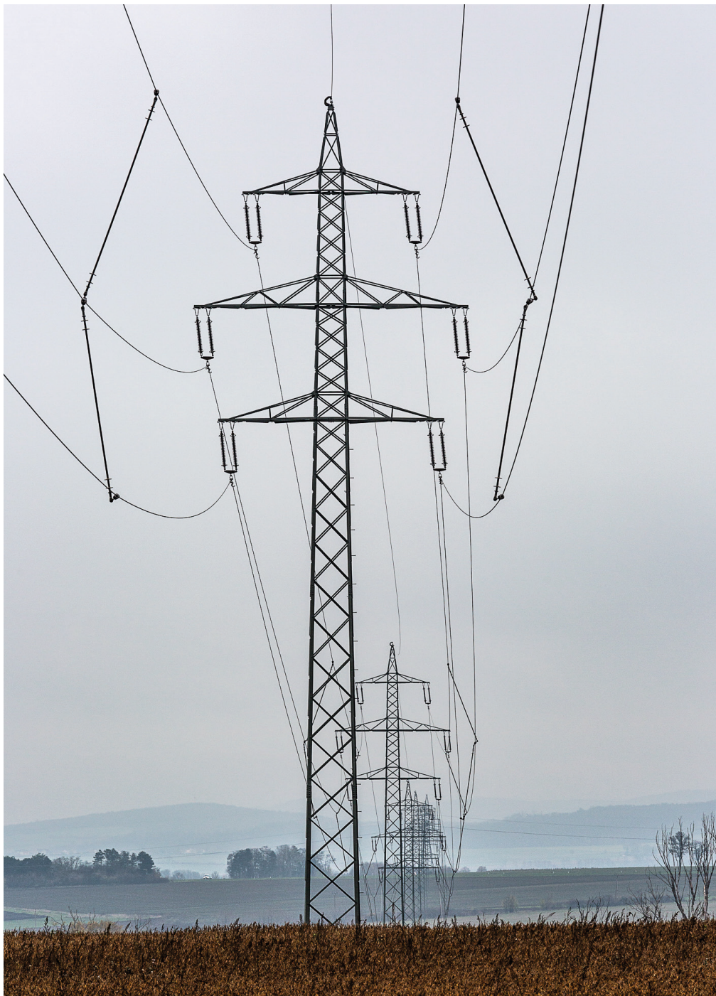
Das 110-kV-Stromverteilernetz von rund 700 Kilometern Länge durchzieht Österreichs östlichstes Bundesland. © www.martingold.at
