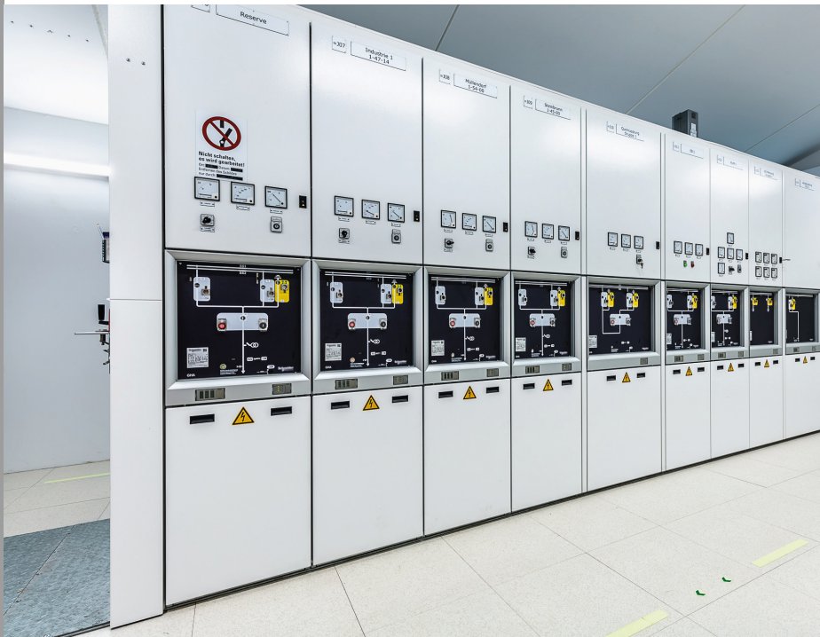
Das Engineering der Schaltschränke und -tafeln erfolgt auf Eplan Electric P8. © www.martingold.at
